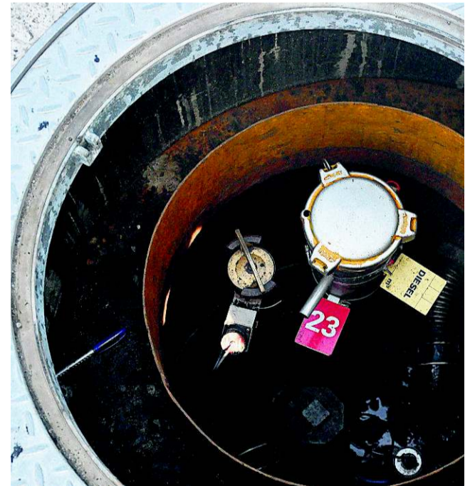
Ein Domschacht, wie er sein sollte: Die Nachfüllstutzen sind doppelt geschützt. Wasser dringt kaum ein.
