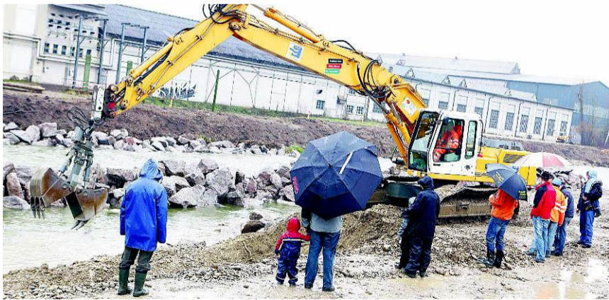
März 2011 beim Stahlwerk Gerlafingen – seither sind die Bauarbeiten an der Emme weit fortgeschritten. FELIX GERBER
